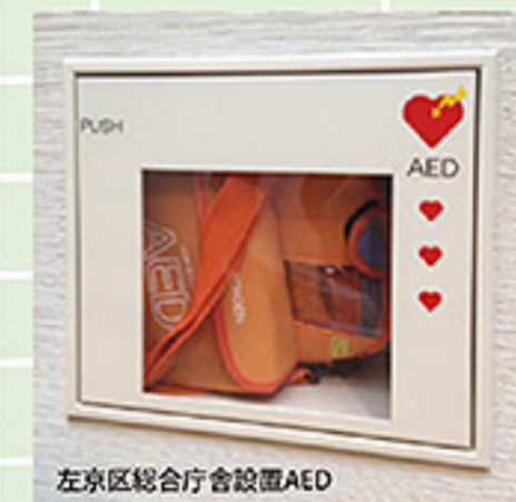
左京区総合庁舎設置AED
